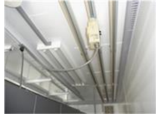
電源レールとブレーカー
